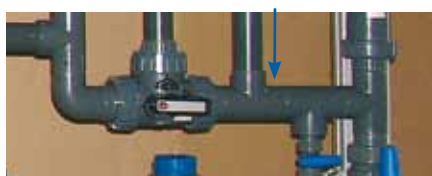
Tuyauterie de by-pass très courte
